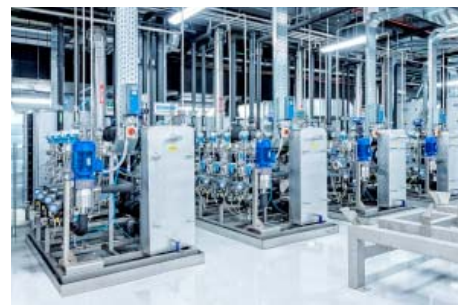
Фото 3. Пример центральной станции, состоящей из нескольких модулей CIP
