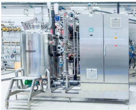
Фото 2. Отдельная установка CIP/WIP
