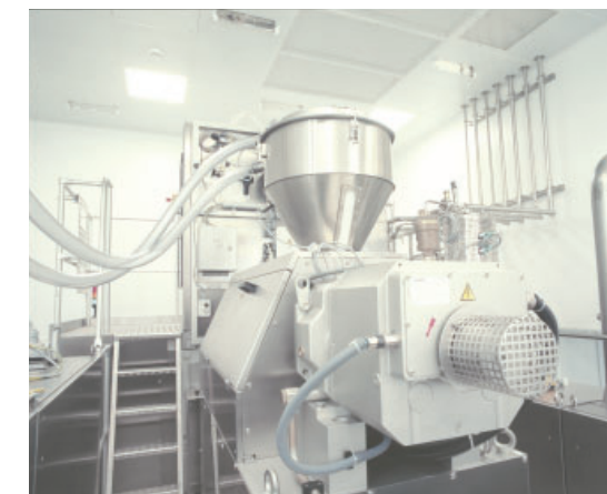
Автоматическая линия «выдувание-наполнение-герметизация» Bottelpack (R) 4010M
